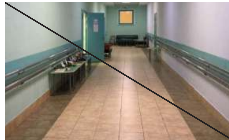
Плохо Керамогранитная плитка с крупными швами
