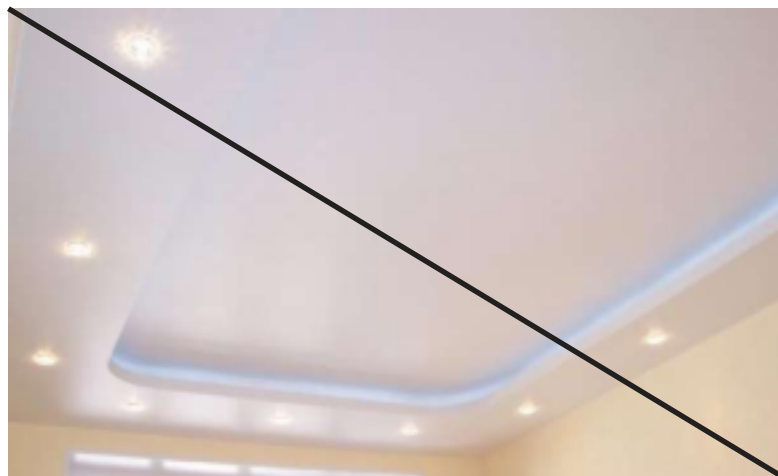
Плохо Многоуровневые гипсокартонные конструкции
